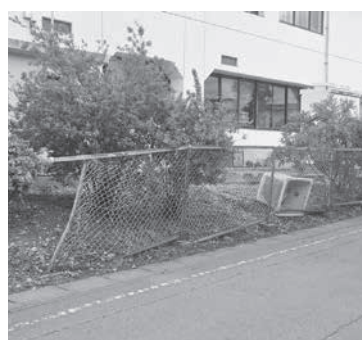
早めの修理・修繕を
