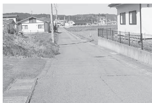
雨のたびに冠水が見受けられる村道「本町泉沢線」
