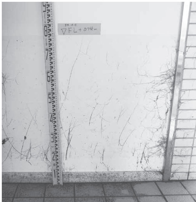
令和元年 10 月の洪水により浸水
