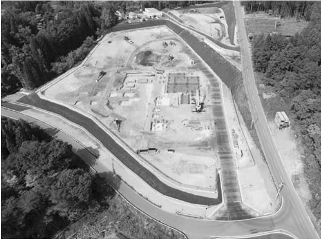
14MWの電力が村で発電されます（上明内地区）
