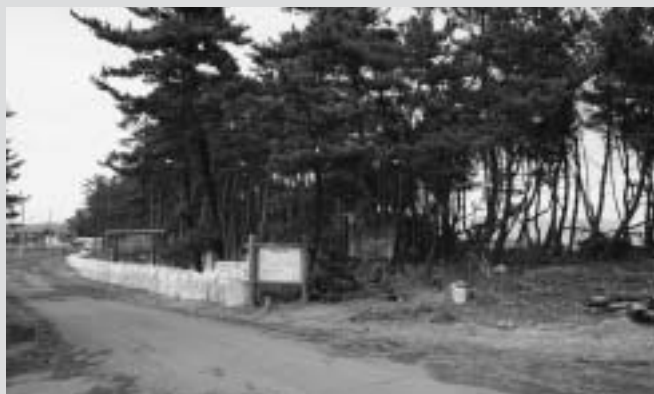
防潮堤が損壊し、高波の際には道路まで波が押し寄せる(右側が海で道路の奥が松川造船所)
