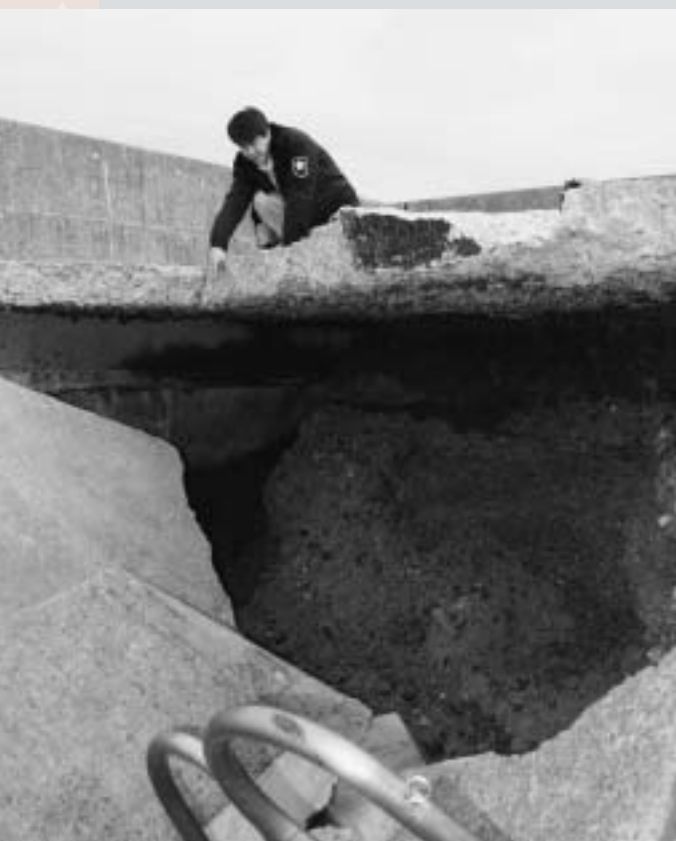
防潮堤のコンクリートの下がえぐられ空洞になっていて危険(十府ヶ浦公衆トイレ付近)
