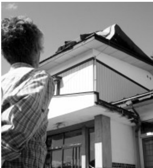
強い風でめくれあがった屋根に呆然
