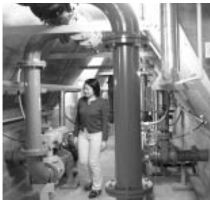
(図2) 地下にある嫌気槽
